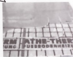
ATHE THERM Fußbodenheizung
