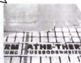
ATHE THERM Fußbodenheizung
